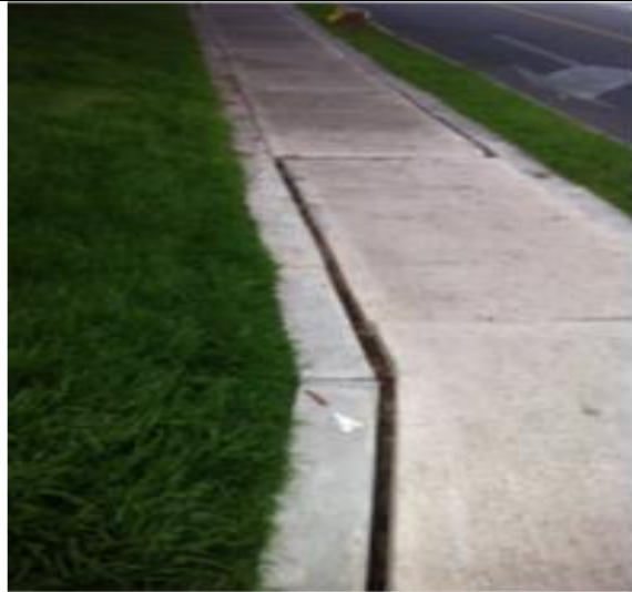
Foto 7. Desnivel y separación de juntas.
