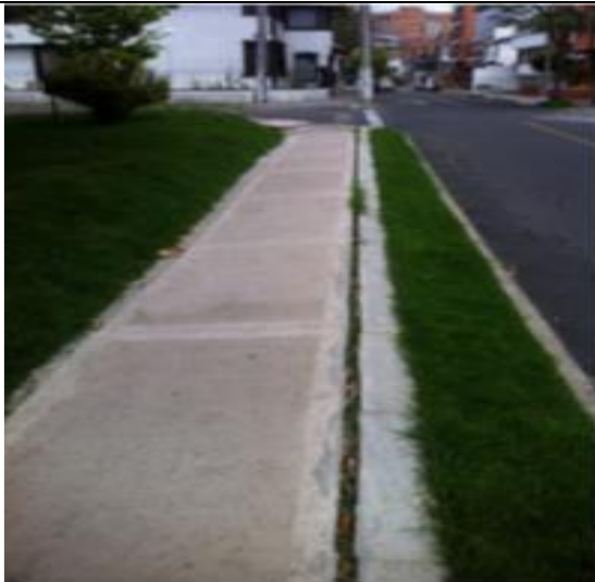
Foto 5. Desnivel y separación de juntas.
