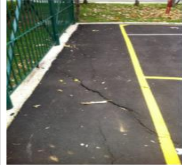
Foto 13. fisuras típicas de piel de cocodrilo
