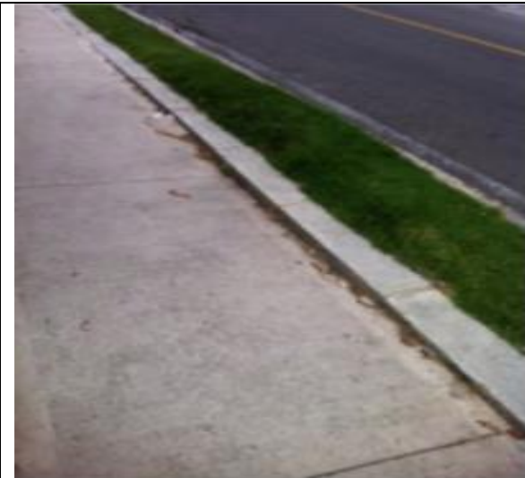
Foto 9. Desnivel y separación de juntas.
