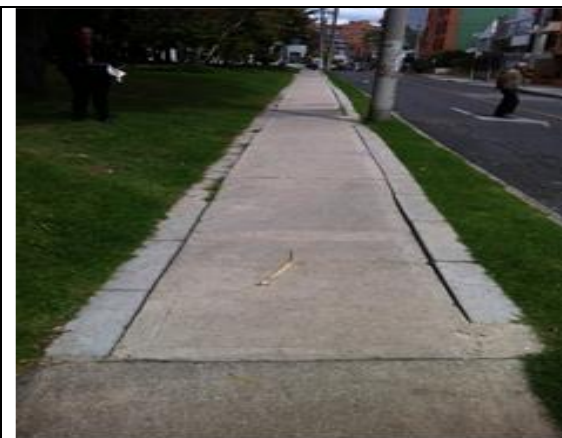
Foto1. Separación de losas
