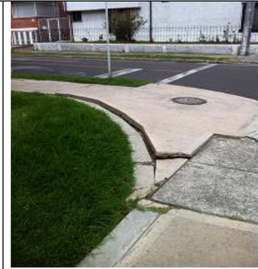
Foto 6. Fisuras y separación de elementos.
