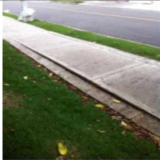
Foto 8. Desnivel y separación de juntas.
