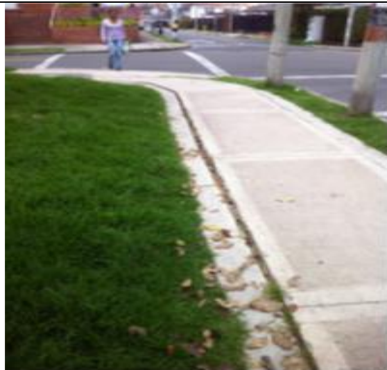
Foto 10. Desnivel y separación de juntas.
