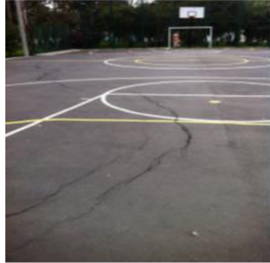
Foto 14. Hundimiento y fisuras
